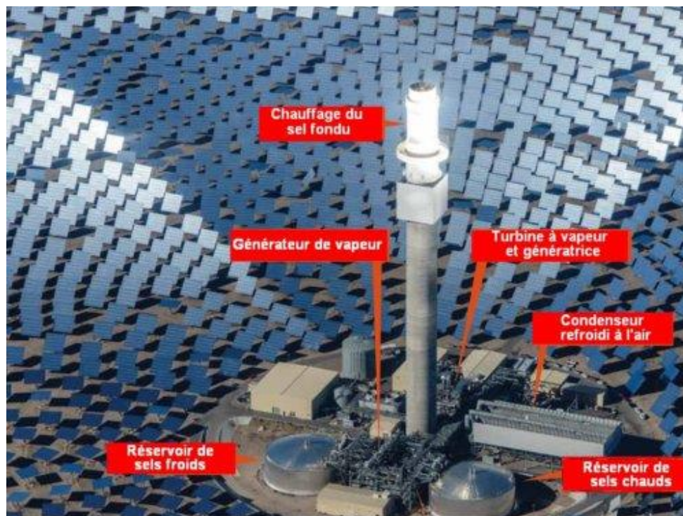
Cœur de l'installation de Crescent Dunes Etats-Unis ©Crédit Solar Reserve
