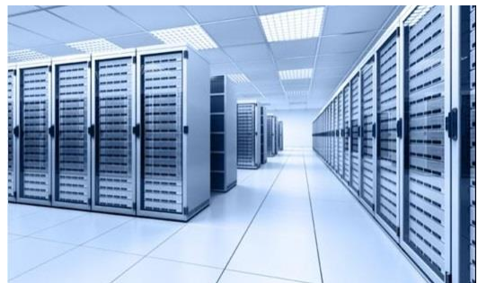
L'intérieur d'une salle serveurs ©By BalticServers.com
